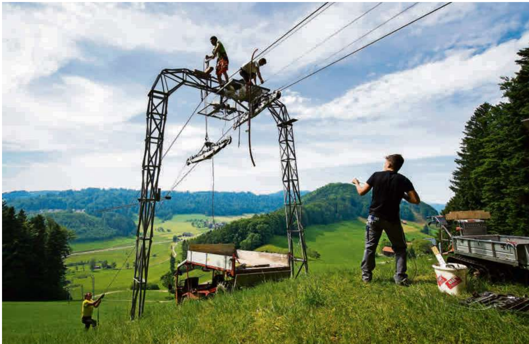
Arbeiten am Steilhang: Die revidierten, 400 Kilogramm schweren Rollenbatterien wurden am Mittwoch wieder installiert.
